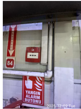
Fire alarm button.JPG
